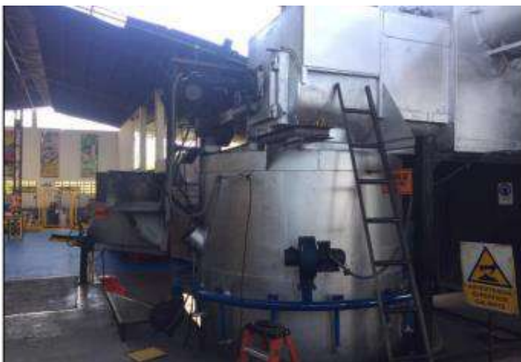
Ilustración 4 Horno incinerador de residuos peligrosos.
