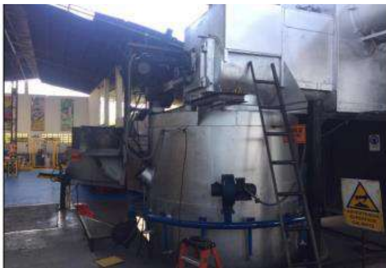
Ilustración 4 Horno incinerador de residuos peligrosos.
